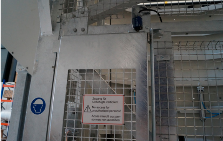
Zona de acceso protegida mediante interruptor de límite conforme a UVV.
