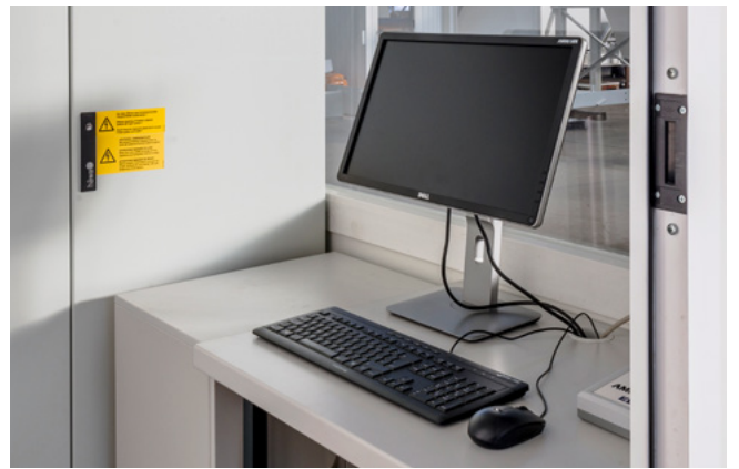
Caseta integrada con sistema de control de la planta.
