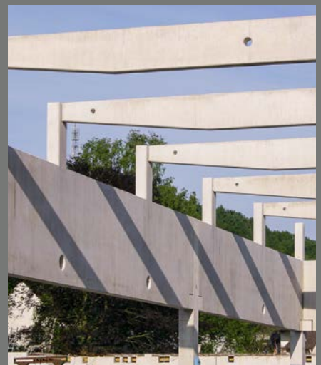
STAHLBETON STÜTZEN UND TRÄGER
