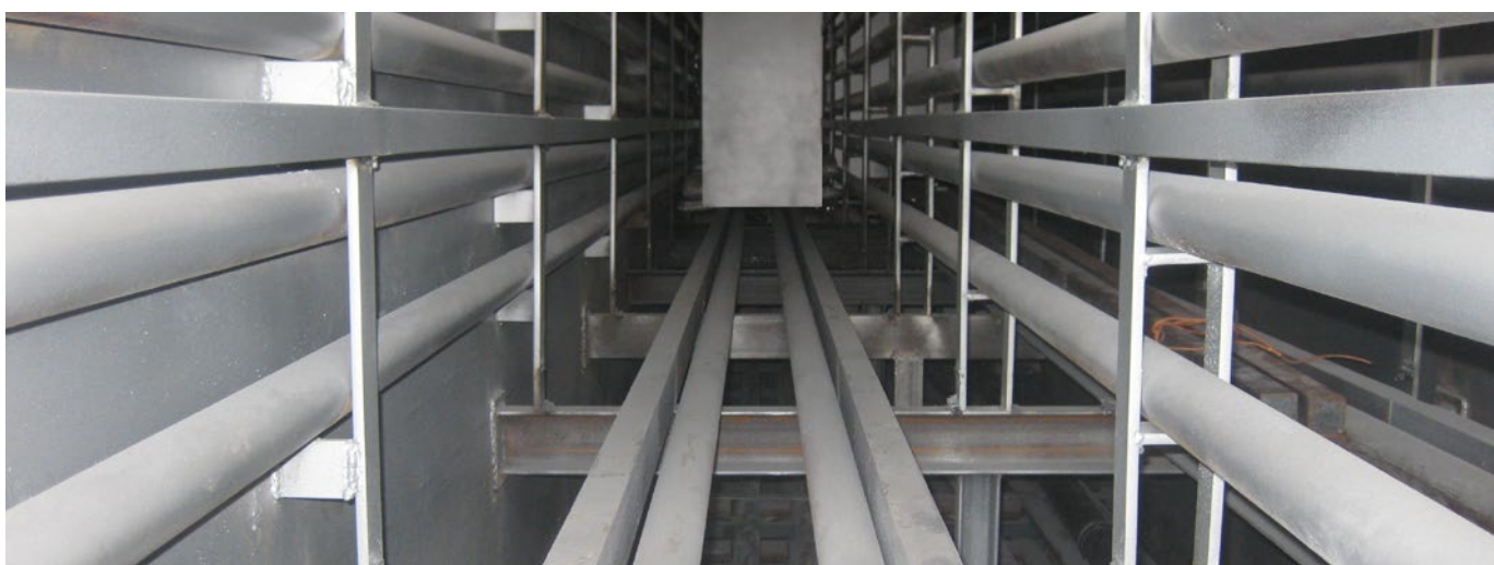
Conduites de chauffage.
