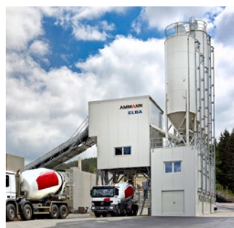
Centrales à béton
