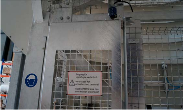
Zone d'accès sécurisée par un fin de course conformément à la directive sur la prévention des accidents (UVV).
