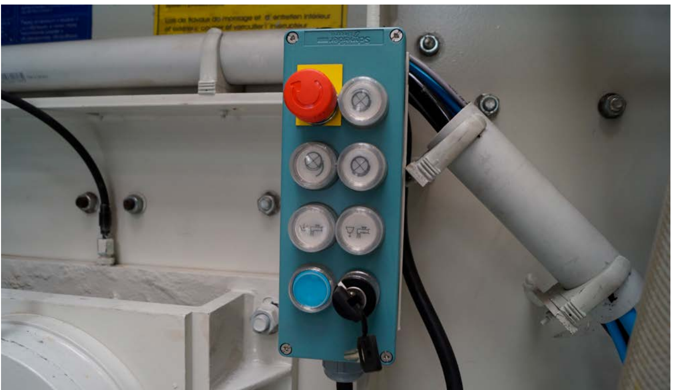
Une télécommande au niveau du malaxeur pour faciliter les travaux de maintenance et d'entretien.
