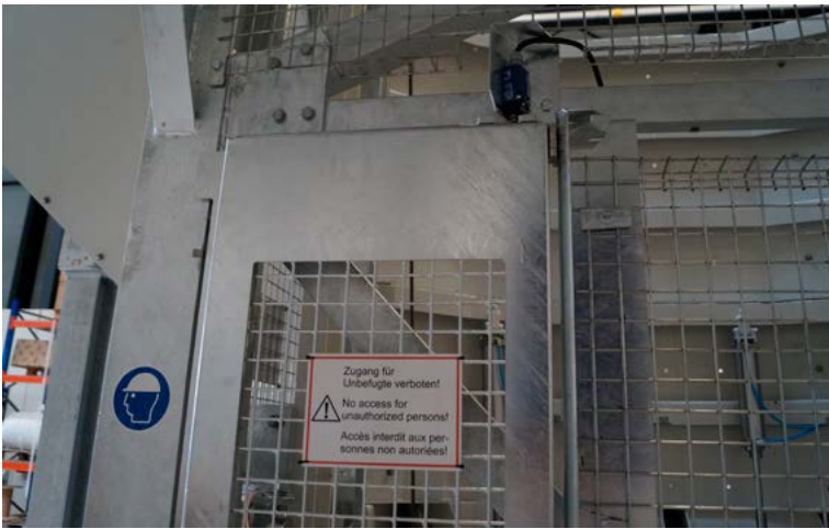
Zugangsbereich Endschaltergesichert gemäß UVV.
