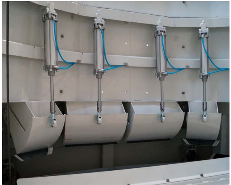
Dosierbox mit eingebauten pneumatisch betätigten Dosierschließern und 1500 kg Zuschlagstoffwaage.
